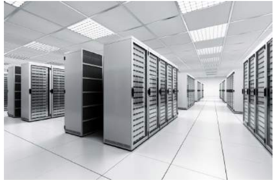
Fig. 4.4 : A data center
